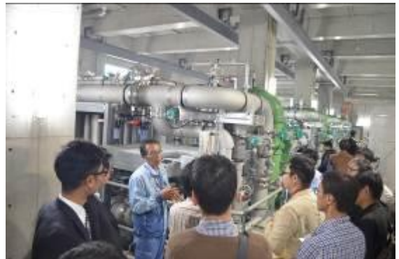
浄水場施設の見学
