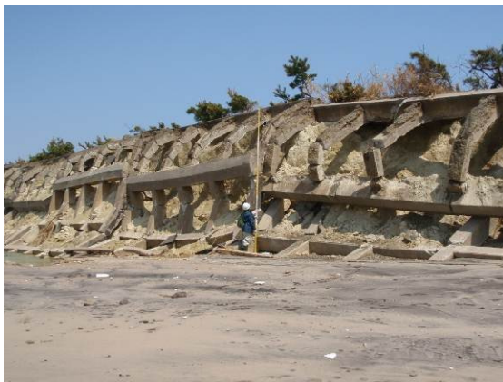
写真7: 山元町の海岸堤防(引波で陸側が崩壊)
