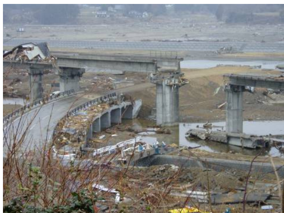
写真 1:高架鉄道の落橋
