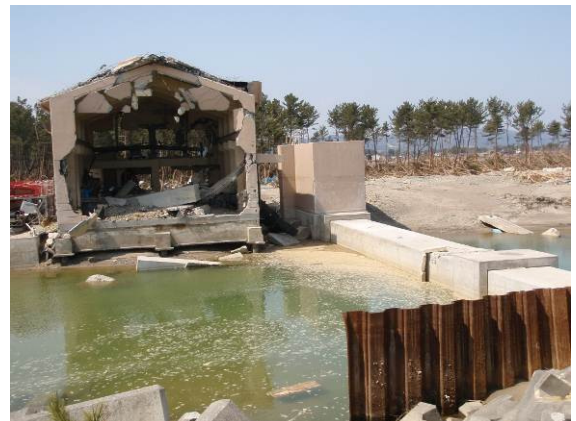
写真8: 全壊した排水機場と露出した排水樋管
