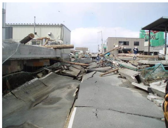
写真 2:壊滅した臨港道路
